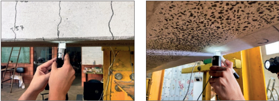
FIGURA 6 AFERIÇÃO DA ABERTURA DE FISSURAS COM MICROSCÓPIO DIGITAL FONTE: PEREIRA (2024)
