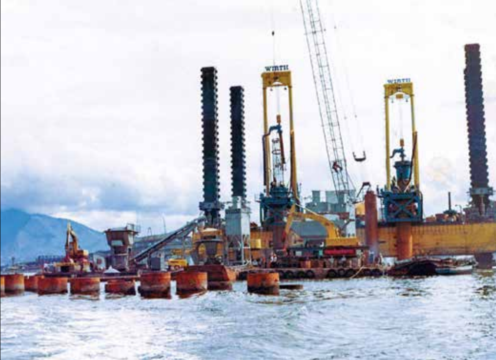
Conjunto Ilha Flutuante e Equipamento Entubador e Perfurador, atuando na construção de tubulões tipo Bade-Wirth
