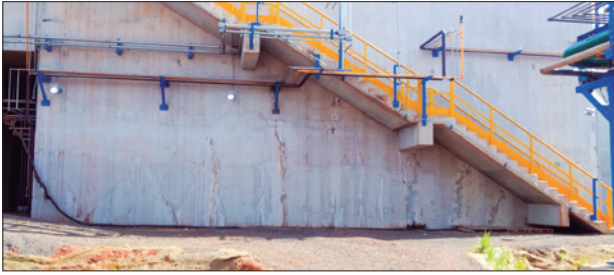
FIGURA 12 MANCHAS DO PROCESSO DE PERCOLAÇÃO DA ÁGUA PELAS FISSURAS DE RETRAÇÃO OCORRIDAS DURANTE A CURA DO CONCRETO – ETA – FÁBRICA DE CELULOSE
