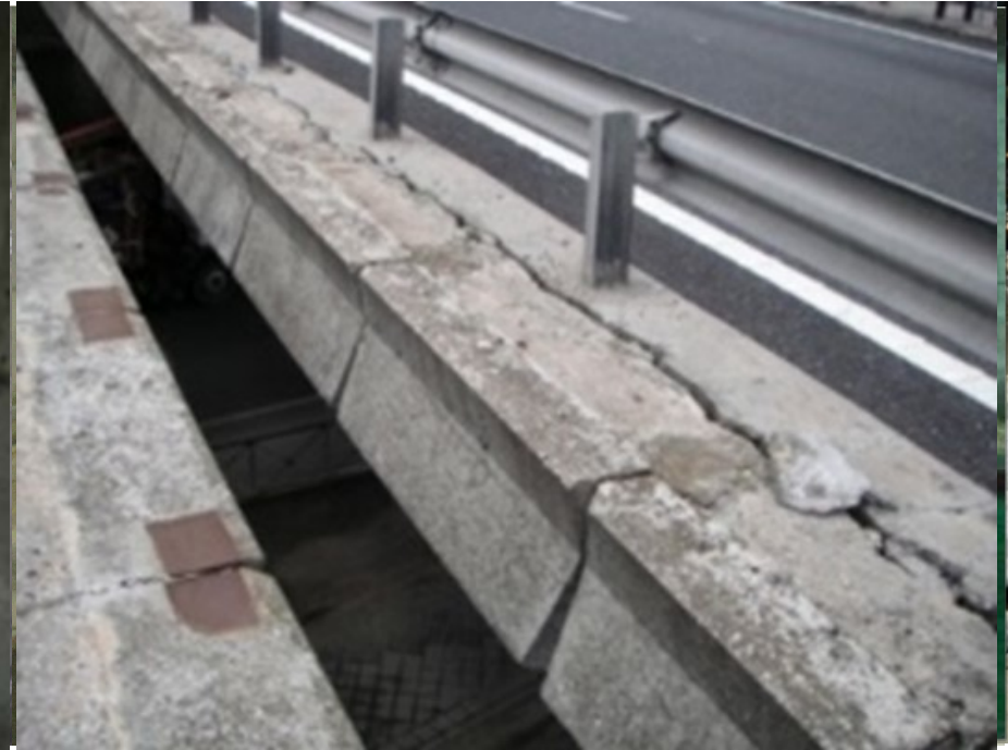
DESINTEGRACIÓN EN LOS ALMOCANOS DE ELEMENTOS MASIVOS
