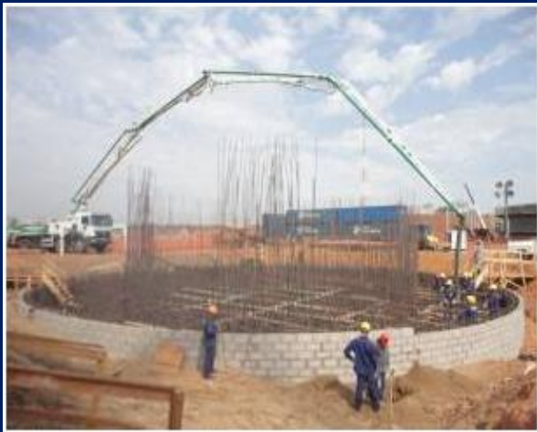
Bloco de fundação da chaminé da fábrica Eldorado-MS; v \sim 1390\text{m}^3 (arquivo Deseq, 2010)
