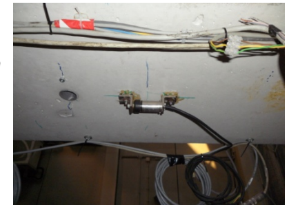
Aberturas de fendas (Fissurómetros)
