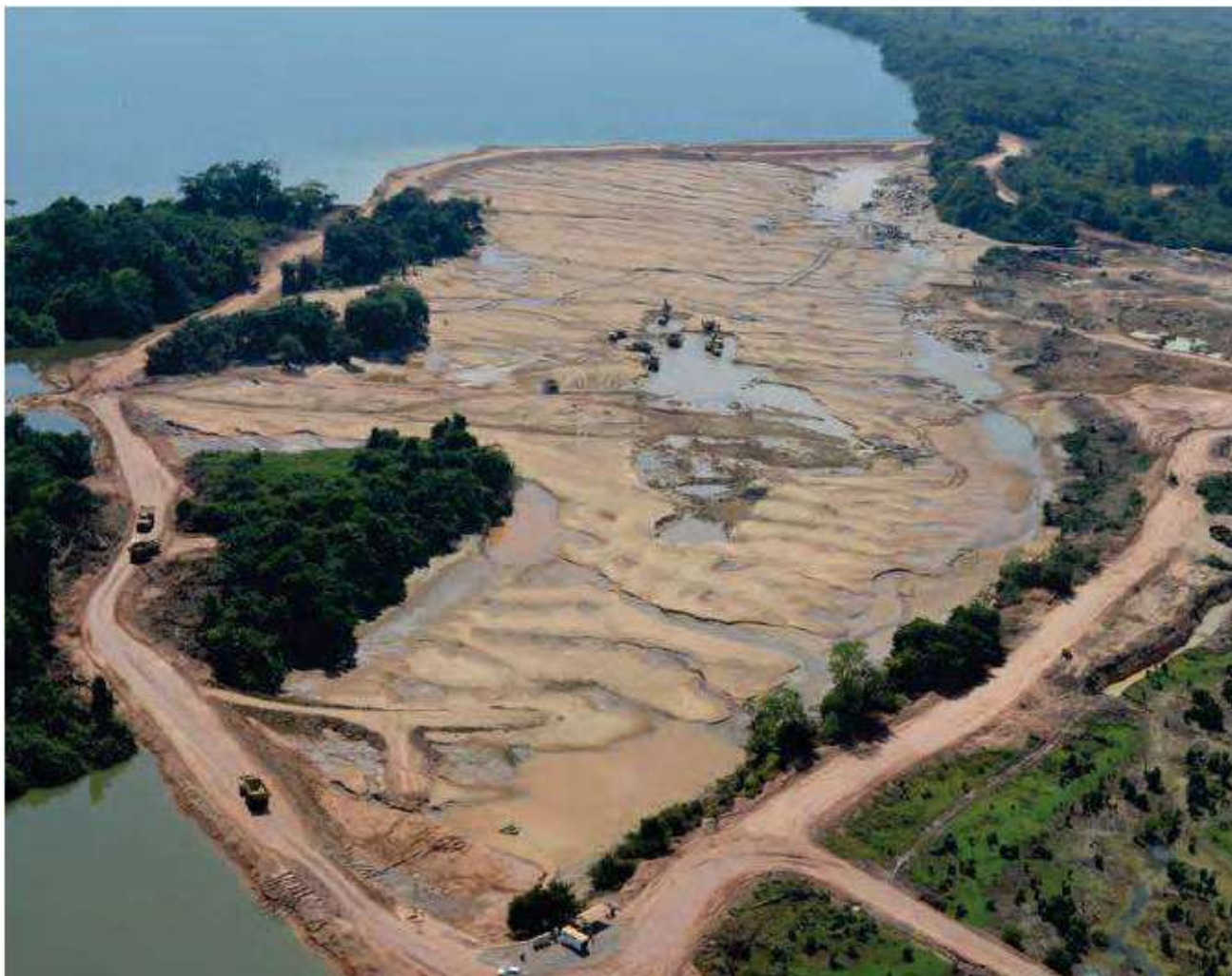
Sítio Belo Monte Ensecadeira de 1ª Fase do Canal de Fuga - Vista Aérea
