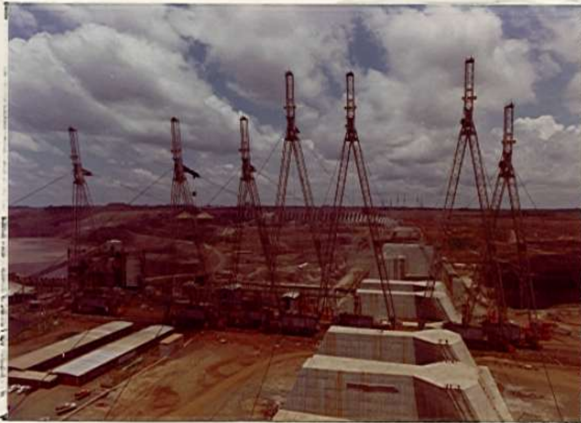
Figura 31 (17649-C) - Vista da área de atuação do conjunto dos cabos aéreos.
