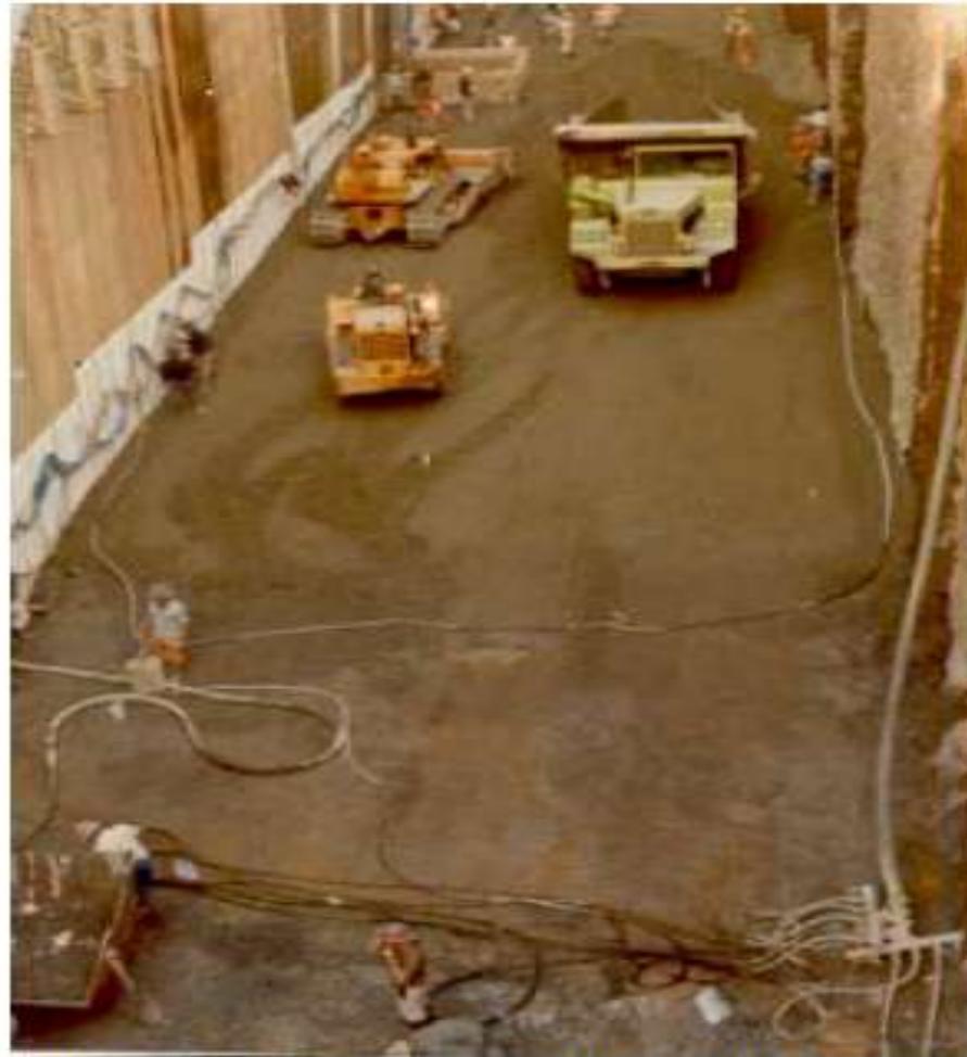
Foto 41 – Detalhe do lançamento, em 1978, de Concreto Compactado com Rolo em caráter experimental, em Itaipu, onde são vistos os equipamentos básicos:
