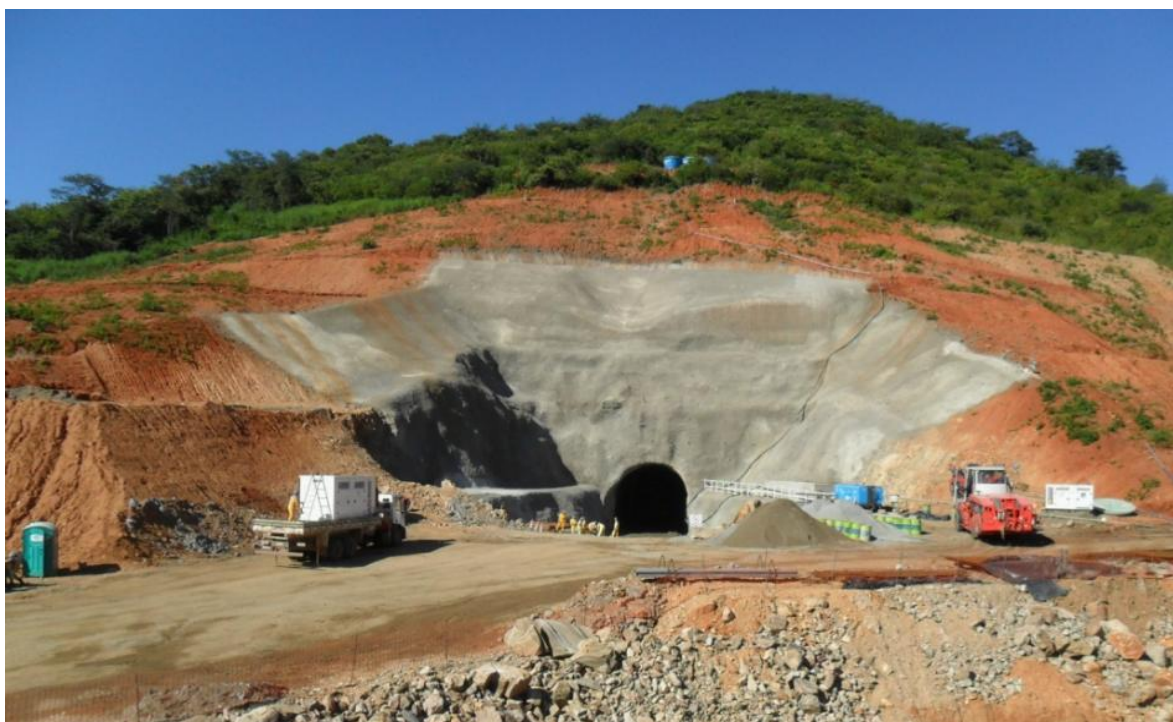
Figura 9- Desemboque do Túnel Cuncas II da Transposição do Rio São Francisco (Almeida 2011)
