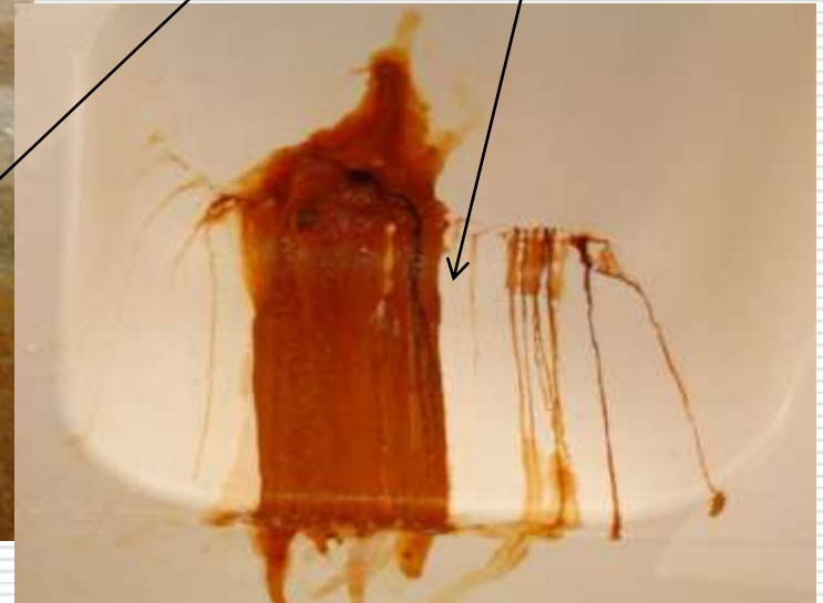
Escoriações de água com produtos de corrosão da malha de aço
