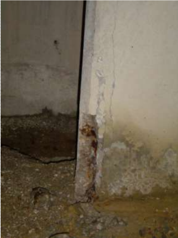
Corrosão dos pilares
