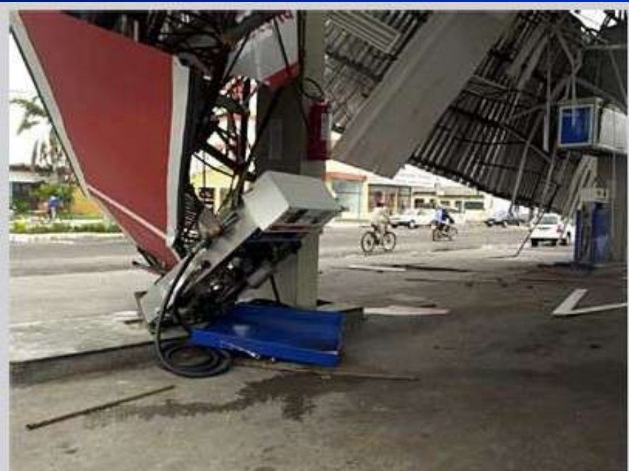
Posto de gasolina, em Torres, foi completamente destruído
