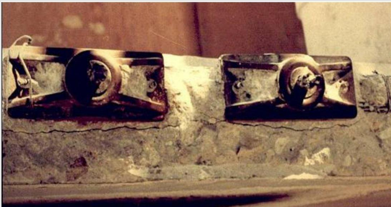
CORROSÃO GRAVE EM ANCORAGENS DE PROTENSÃO
