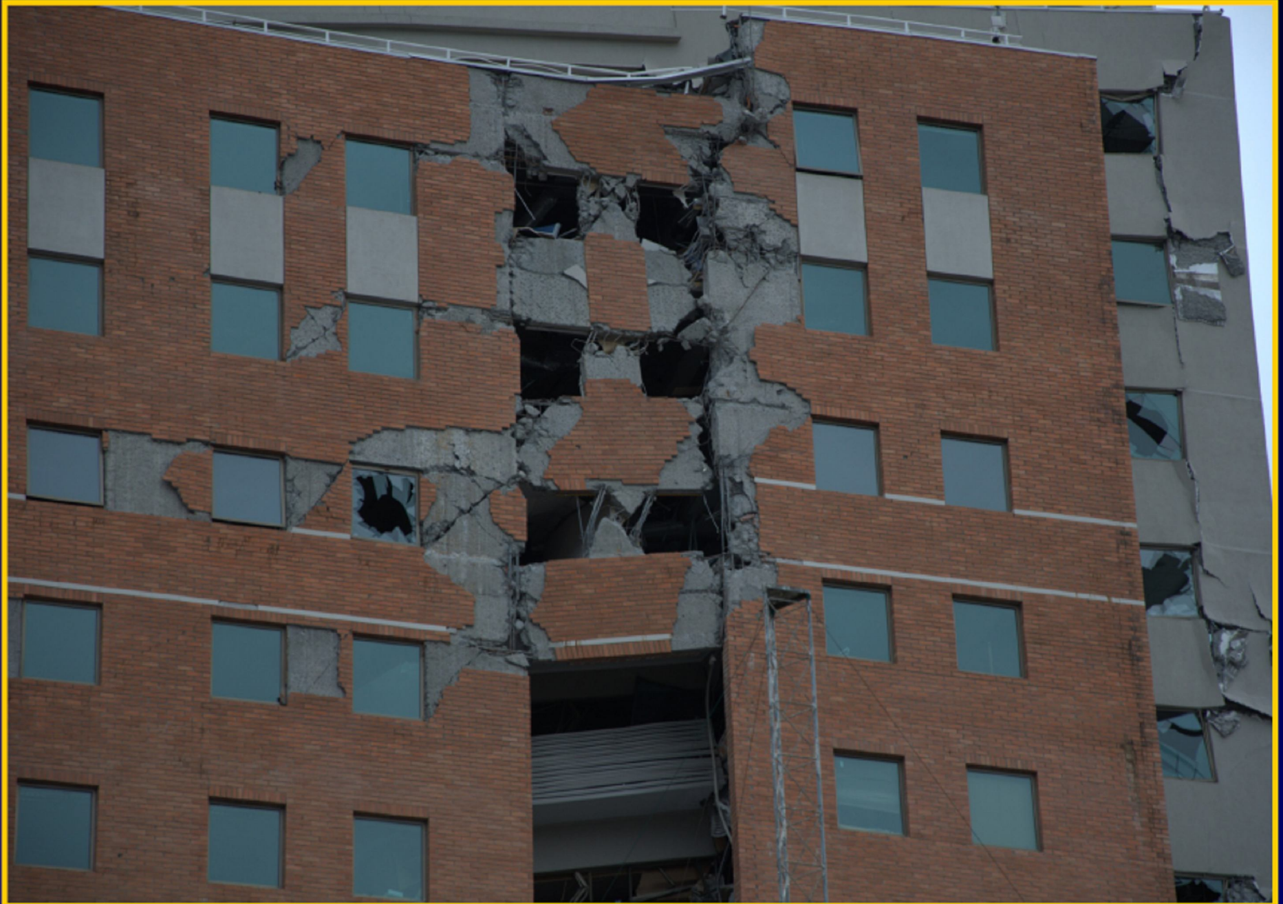
Daño severo vigas (plano de unión con columnas)
