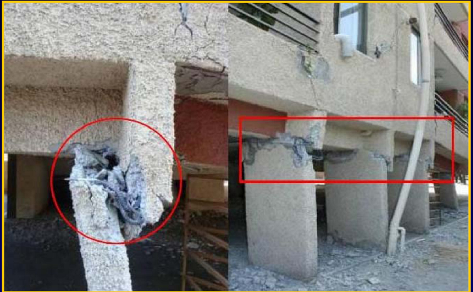
Falla de Piso blando. Primer nivel
