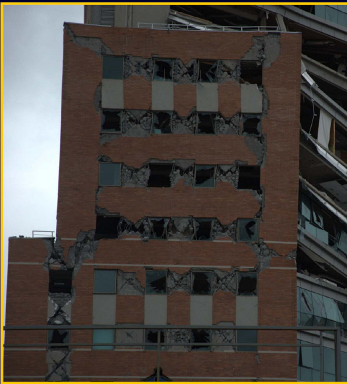
Daño severo en columnas
