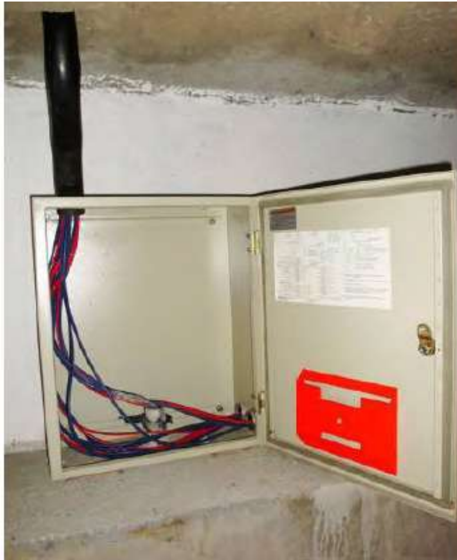
Caixa do sistema de monitoramento
