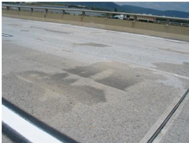
Antes do tratamento (concreto)
