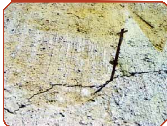
Figura 2 – Fissuração tipicamente causada por retração plástica em um concreto recém-lançado em uma laje. ABCP, 2003
