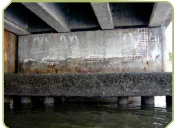
Figura 5 – Detalhe de outro pilar-parede com corrosão generalizada, com perda de seção das armaduras
