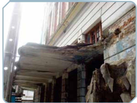
Foto 5 – Trecho da marquise M3 que colapsou
