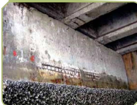
Figura 7 – Detalhe do pequeno recobrimento das armaduras em outro pilar-parede da ponte, com apresentação de corrosão com perda de seção das armaduras
