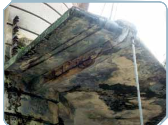
Foto 6 – Consolo com armaduras corroídas e lajes fissuradas apresentando infiltração generalizada
