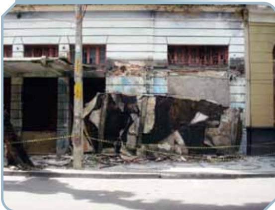
Foto 4 – Colapso total de parte da marquise M3
