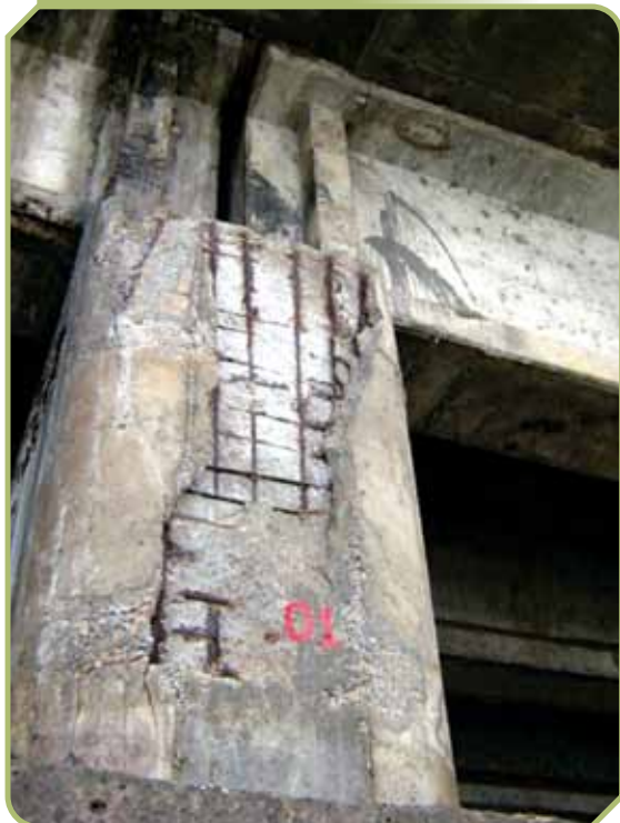
Figura 6 – Vista da corrosão existente em outro pilar-parede da ponte, com perda de seção das armaduras e expansão do concreto existente
