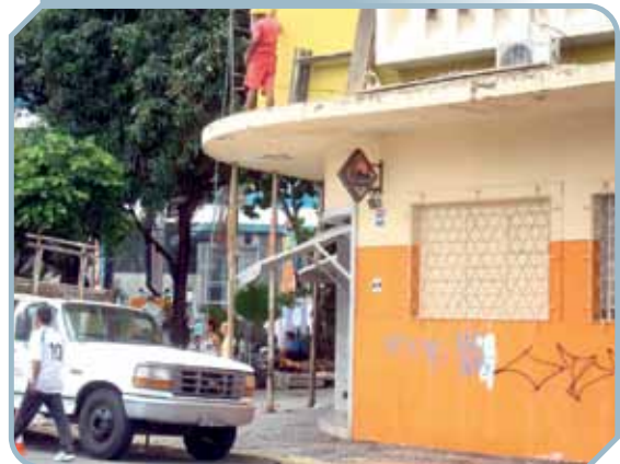
Foto 3 – Escoramento incorreto da M2 no centro do Recife
