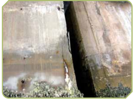
Figura 4 – Detalhe da fissura causada pela expansão do concreto devido à corrosão das armaduras em um pilar-parede da ponte
