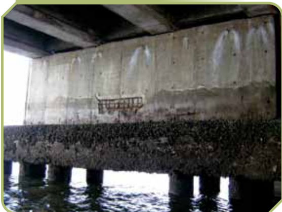
Figura 3 – Vista lateral de um pilar-parede da Ponte apresentando corrosão das armaduras, com perda de seção e pequeno recobrimento das armaduras (2 cm)
