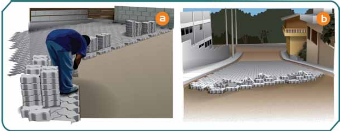
Figura 6 – a - Maneira correta de organizar a obra (esquerda). b - Peças de concreto transportadas e colocadas de modo inadequado (direita)
