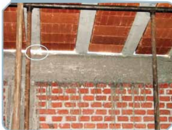
Figura 4 - Contraflecha exagerada erguendo as extremidades das vigotas
