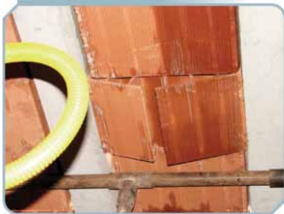
Figura 1 – Quebra de bloco cerâmico
