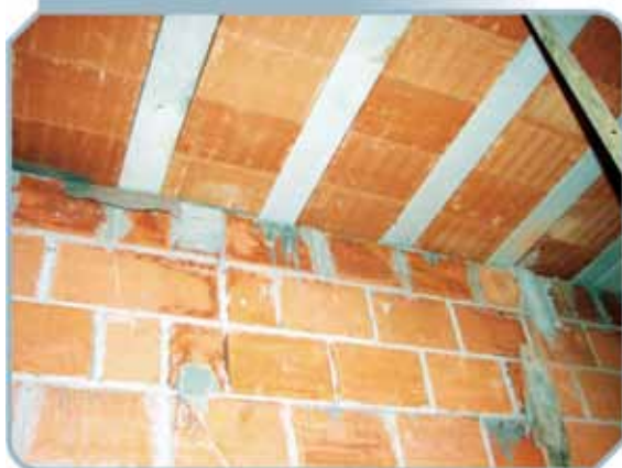
Figura 5 – Ausência de cinta de solidarização
