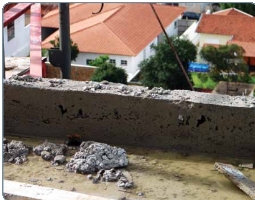
Figura 3 - Conseqüência da baixa qualidade do adensamento: aparecimento de vazios no concreto
