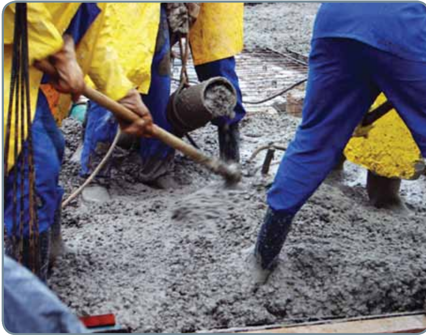
Figura 1 - Descuidos no lançamento do concreto: operários pisando diretamente nas barras, afetando diretamente o posicionamento das mesmas
