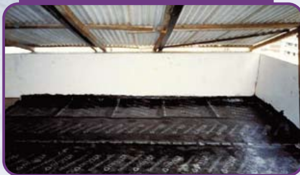
Figura 1 – Manta asfáltica aplicada em laje de piso do último pavimento de condomínio após colapso estrutural da laje da cobertura
