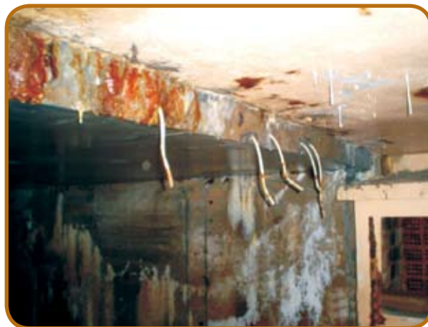
Figura 2 – Eflorescências e estalactites na parte inferior da laje de fundo de canal de água tratada
