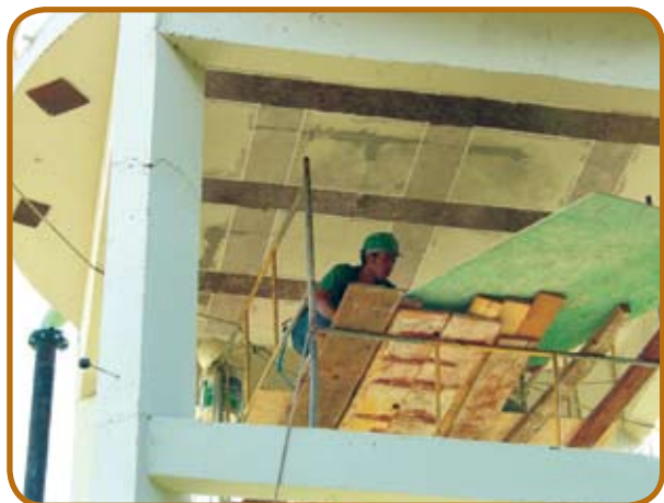
Figura 5 – Reforço de laje de sustentação de reservatório elevado, através de sistema com uso de fibra-carbono
