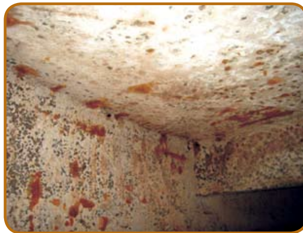
Figura 3 – Deterioração do concreto na parte interna de tanque utilizado para tratamento de esgoto sanitário
