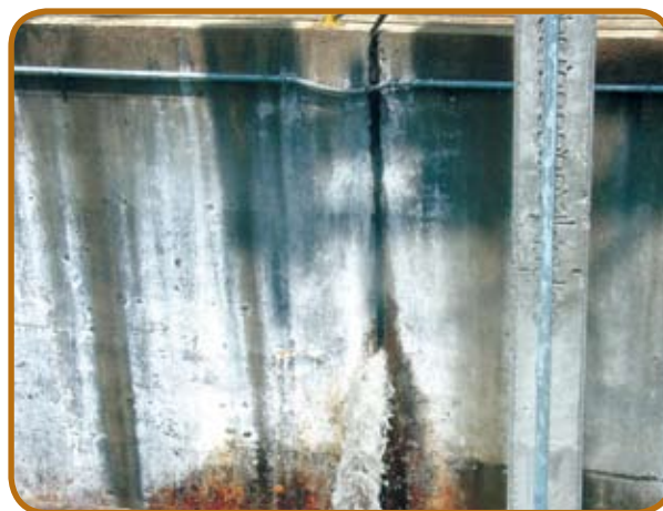
Figura 4 – Água percolando através de junta de concretagem em colapso, em estação de tratamento de água.
