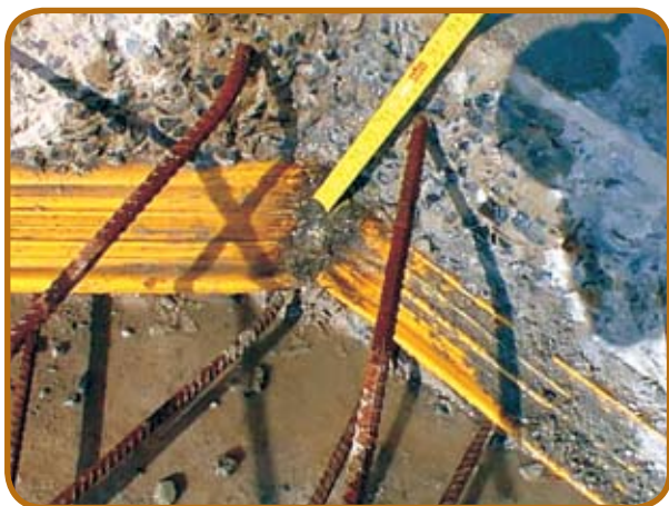
Figura 8 – Segregação do concreto na região das juntas de dilatação
