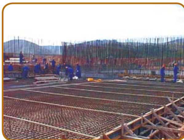
Figura 3 – Densidade da armadura
