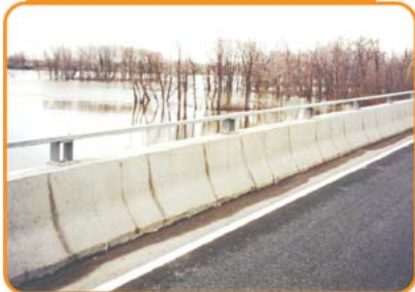
Figura 4 – Exemplo de Fissuras por Retração Térmica em Barreira Rodoviária (Cusson e Repette, 2000)
