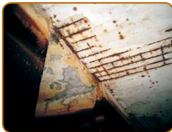
Figura 1 – Corrosão de armaduras em laje de poço de sucção de água potável
