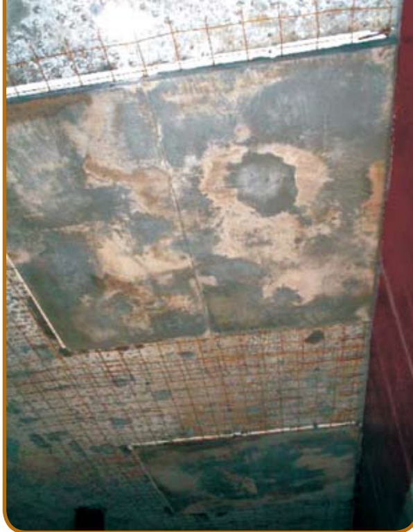
Figura 6 – Recuperação estrutural da laje de tampa de reservatório enterrado de água potável
