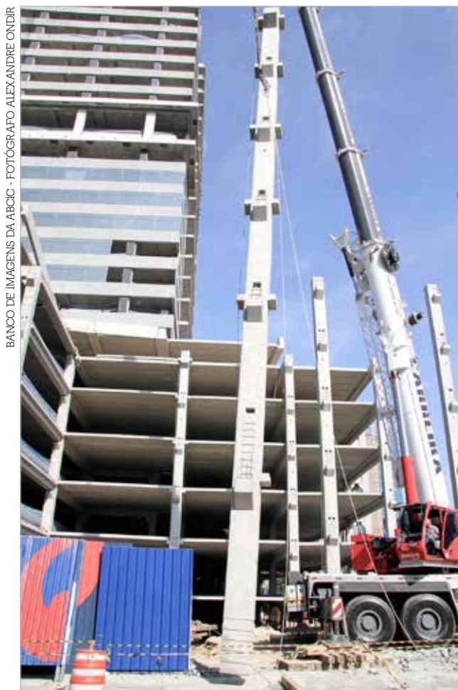
Canteiro de Obras, em São Paulo, durante a montagem de pilares pré-fabricados de concreto, com estrutura do edifício composta por pilares, vigas, lajes alveolares e painéis
