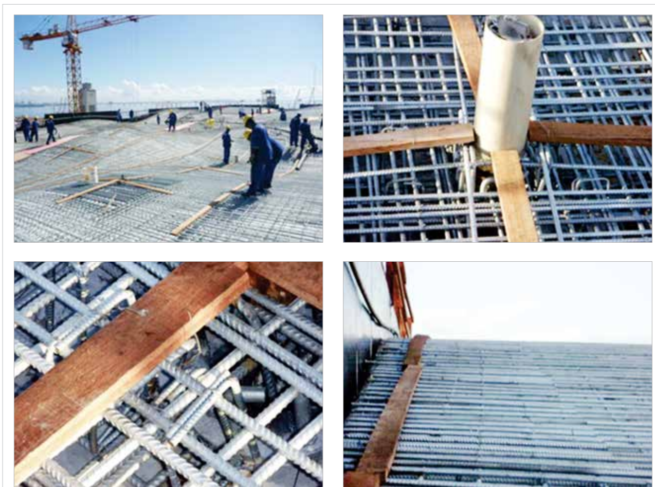
Figura 10 – Aspectos da CF pouco antes da concretagem, ressaltando a densidade de armadura. No canto inferior direito, a elevação que o concreto teve de galgar sem segregar
