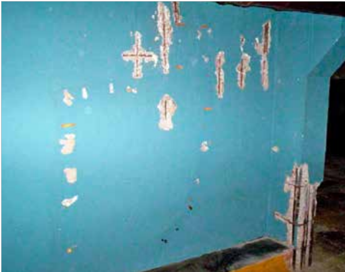
Cobrimento de armaduras insuficiente e corrosão de armaduras
