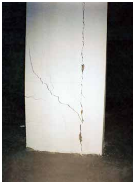
Fissura em pilar de edifício
