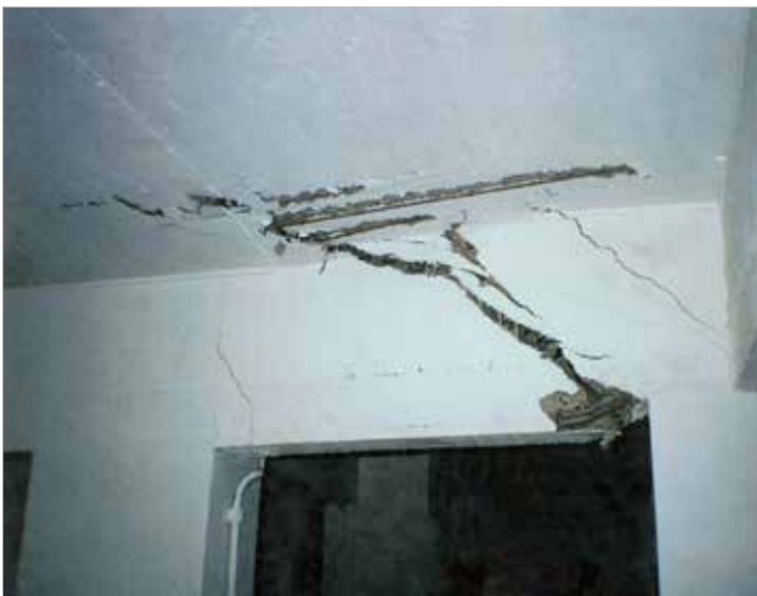
Fissura em viga de edifício
