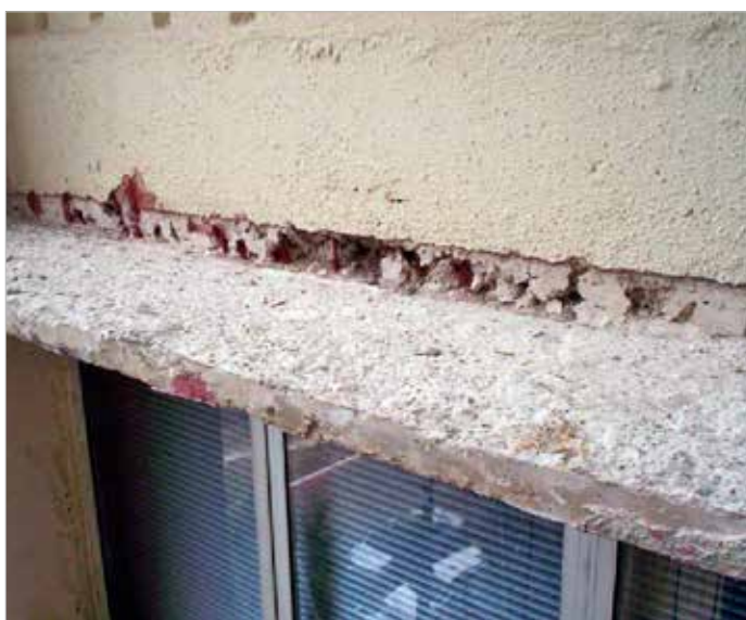
Ninhos de concretagem em elemento estrutural por falha de execução
