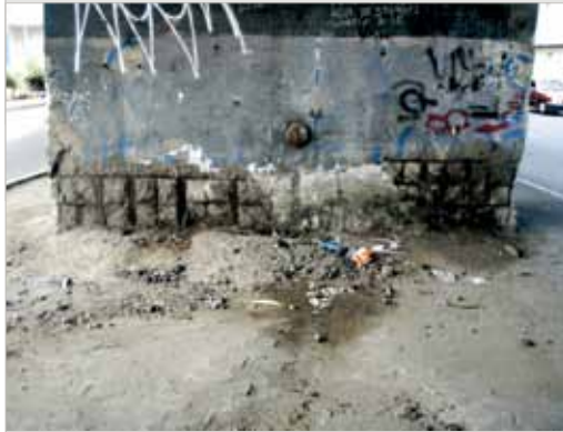
Figura 7 – Corrosão de armaduras principais de pilar
