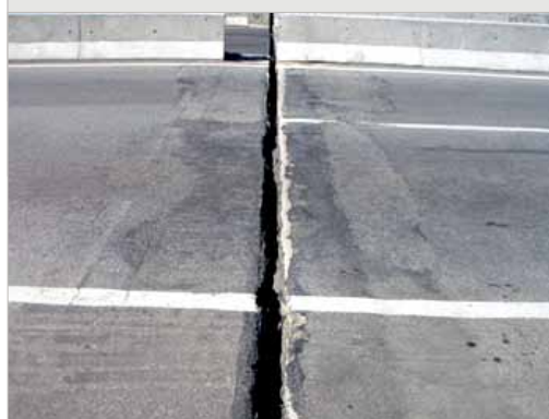
Figura 5 – Defeito em fenda de dilatação apetrechada com selante moldado no local
