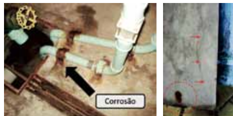
Figura 3 - Exemplos de locais com corrosão instalada
