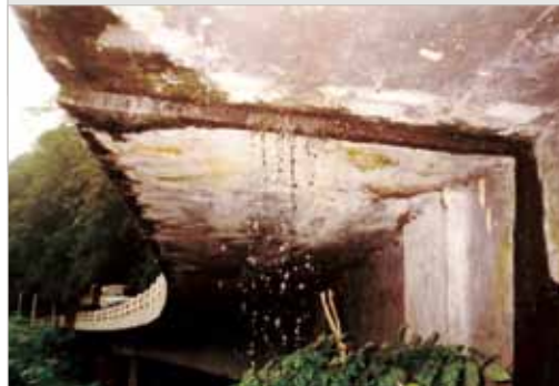
Figura 4 – Ineficácia de junta de dilatação permitindo passagem de água pluvial
