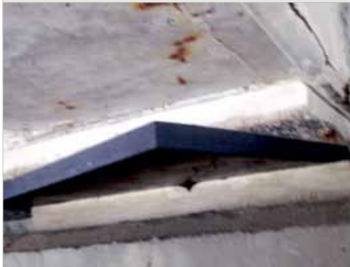
Figura 6 – Instalação errônea de aparelho de apoio, motivando expulsão da almofada do berço de assentamento
