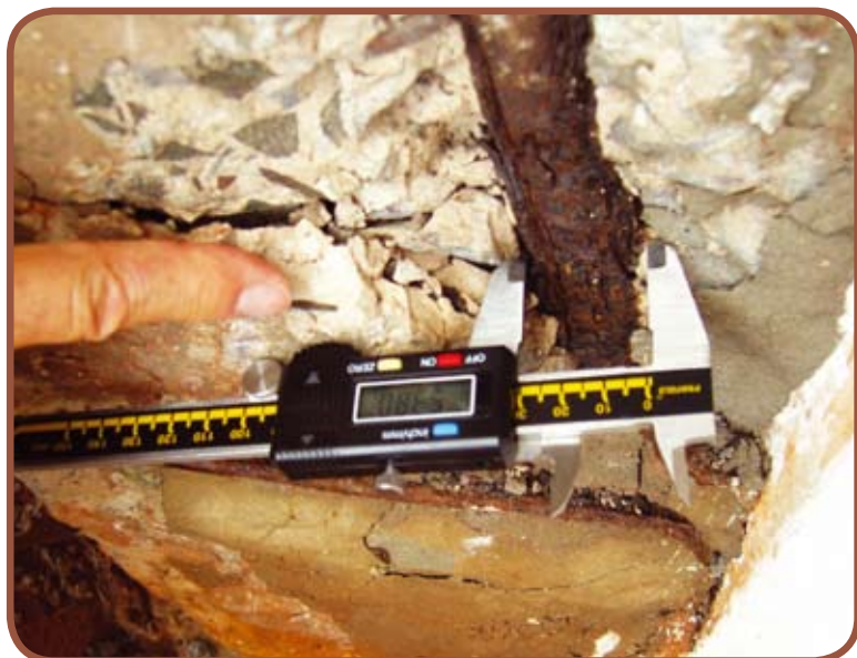
Figura 8: Medição de Perda de Seção por Corrosão
