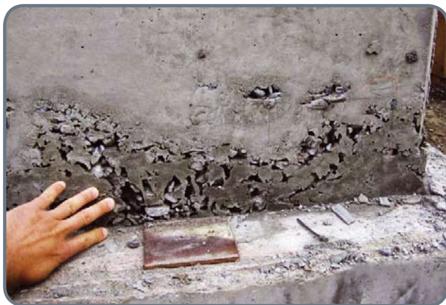
Falha de concretagem conhecida como colmeia de abelha
