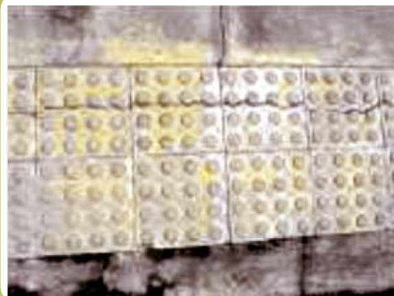
Figura 1 – Ladrilho hidráulico com fissuras
