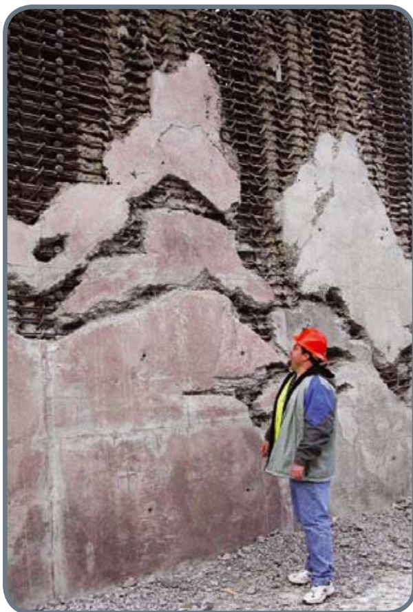
Falha de concretagem – plasticidade insuficiente do concreto
