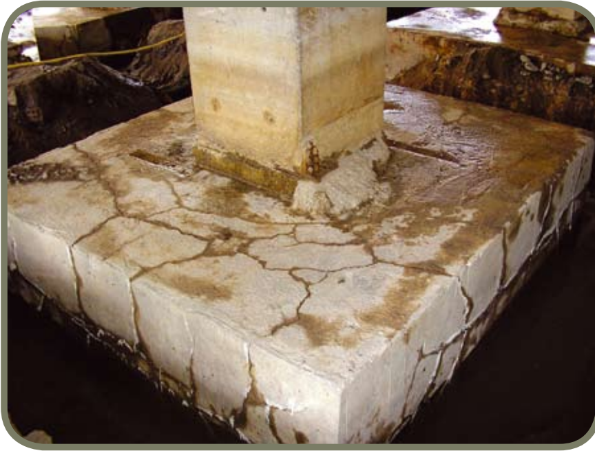
Bloco de fundação do Edifício Rosita Hardman em Recife afetado pela RAA
