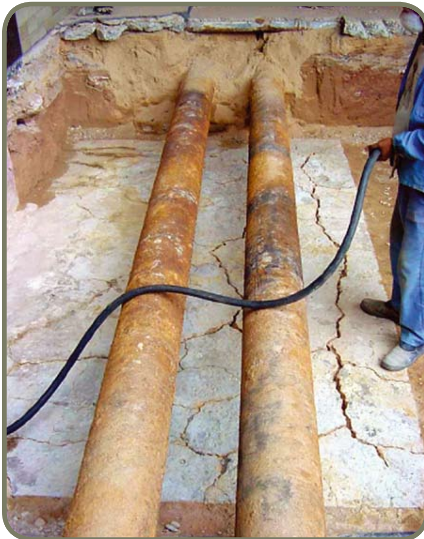
Recuperação de estrutura afetada por RAA em Recife
