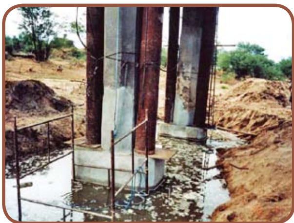
Encamisamento de grout dos pilares com vista dos tubos metálicos para operação de macaqueamento da Ponte Dois Irmãos
