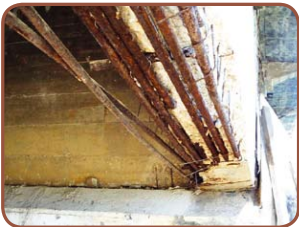
Vista de viga da Ponte Jerônimo Rosado com flambagem localizada, perda de seção e rompimento de armaduras (estribos)
