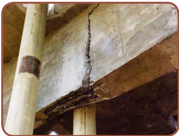
Detalhe de fissura em viga
