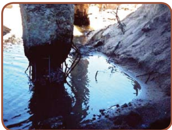
Flambagem localizada das armaduras de pilar da ponte sobre o Rio Dois Irmãos
