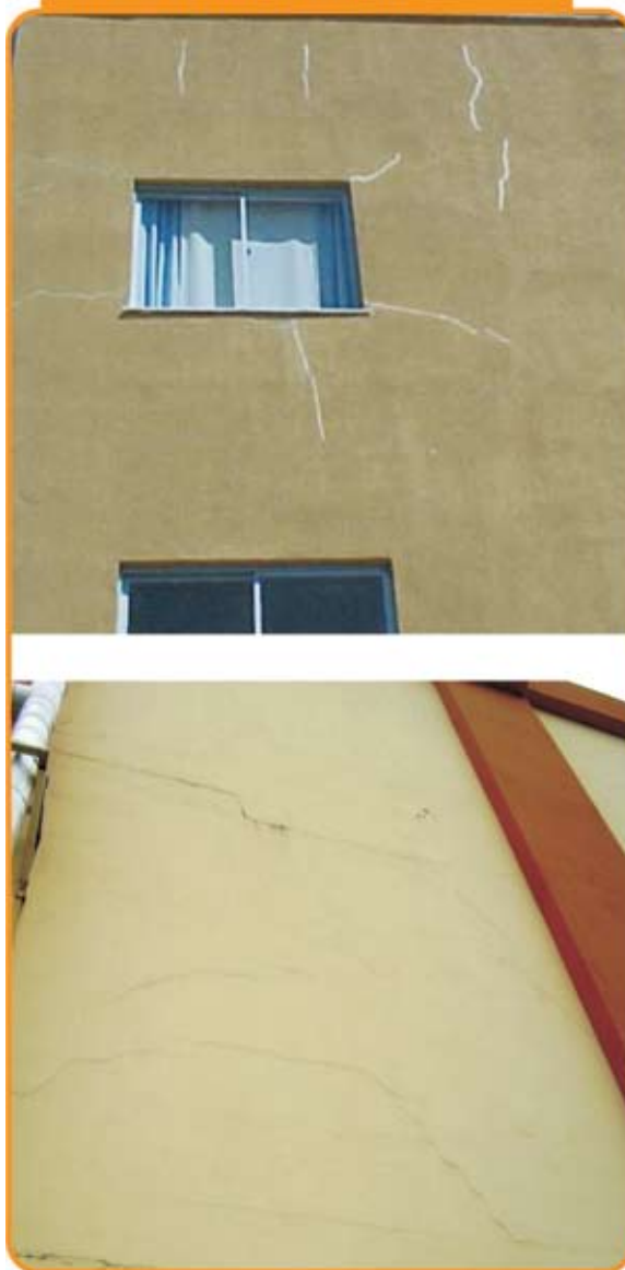
Figura 1 – Exemplo de processo fissuratório em alvenaria
