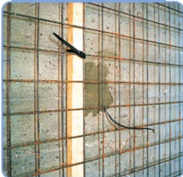
Figura 2 – Detalhe da conexão realizada na armadura no interior do concreto para o exterior, de forma a propiciar a conexão da mesma à fonte retificadora
