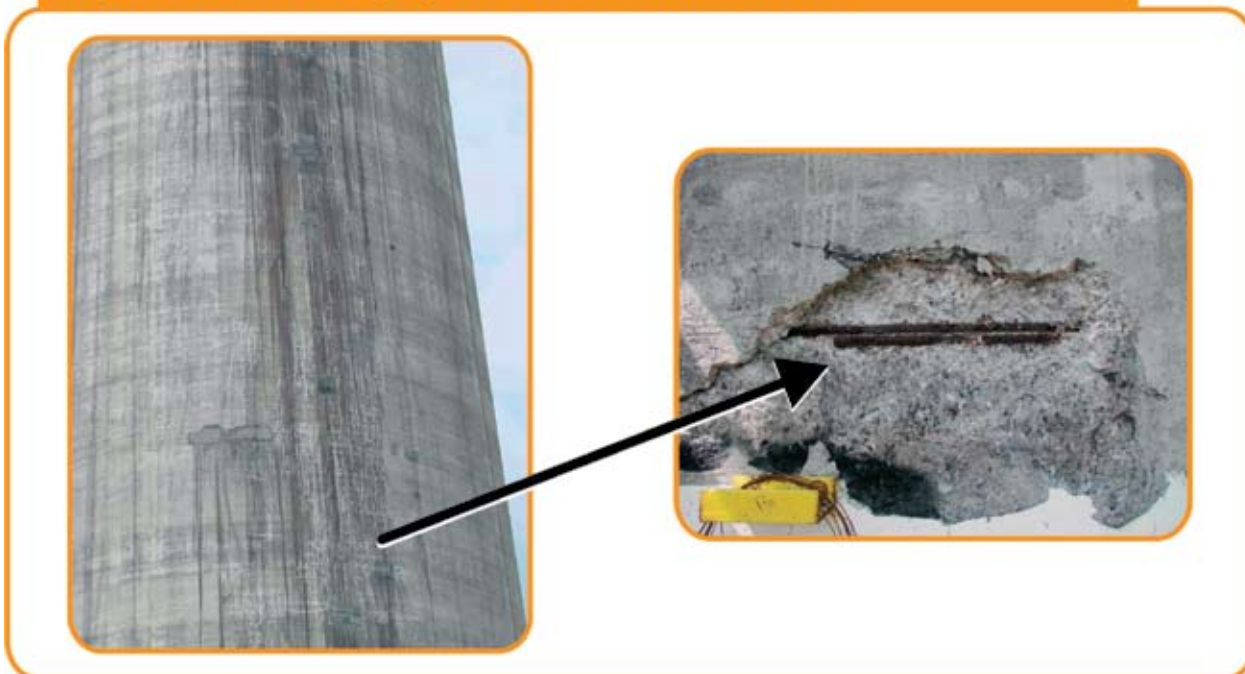
Figura 6 - Fissuras, segregações e corrosão de armaduras
