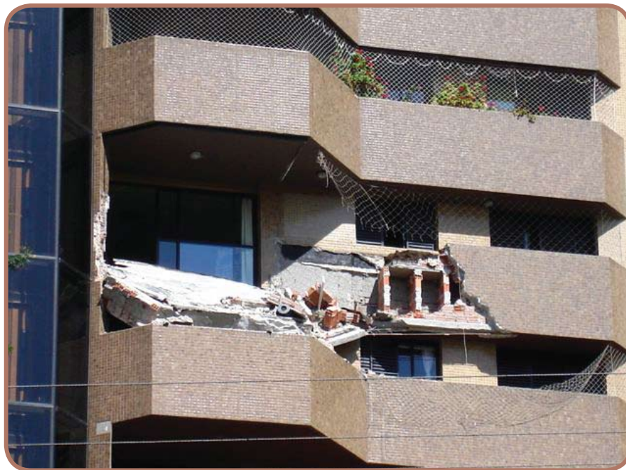
Queda de marquise de prédio em Curitiba (PR, em março de 2007)
